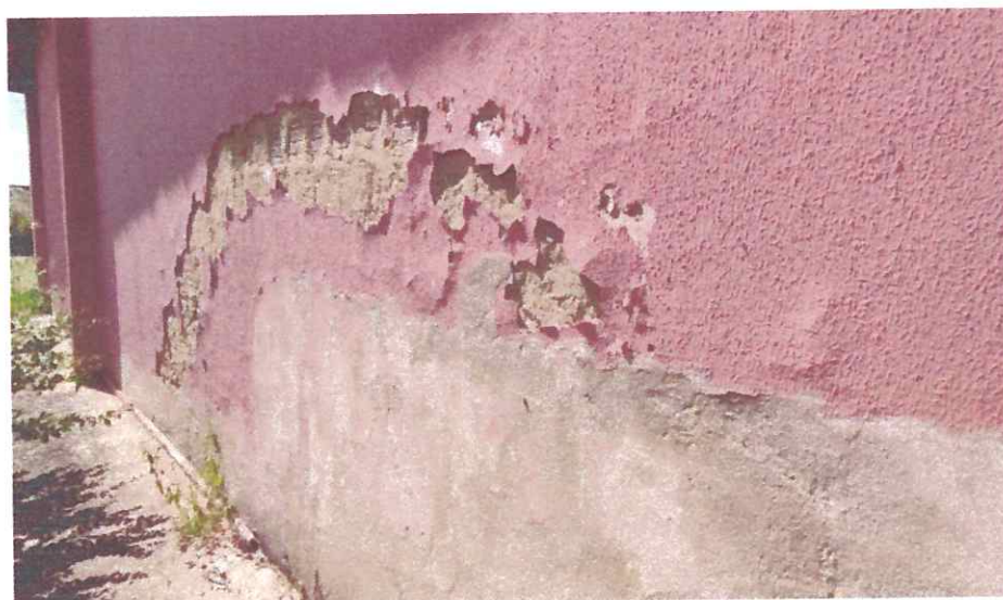
FOTO 03 – REBOCO DA PAREDE DANIFICADO
