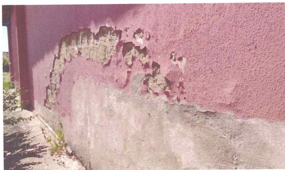
FOTO 04 – REBOCO DA PAREDE DANIFICADO
