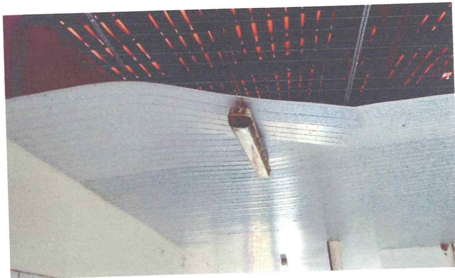
FOTO 01 – FORRO DE PVC DANIFICADO E LUMINARIA
