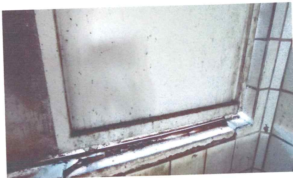
FOTO 02 – JANELA DE FERRO DANIFICADA
