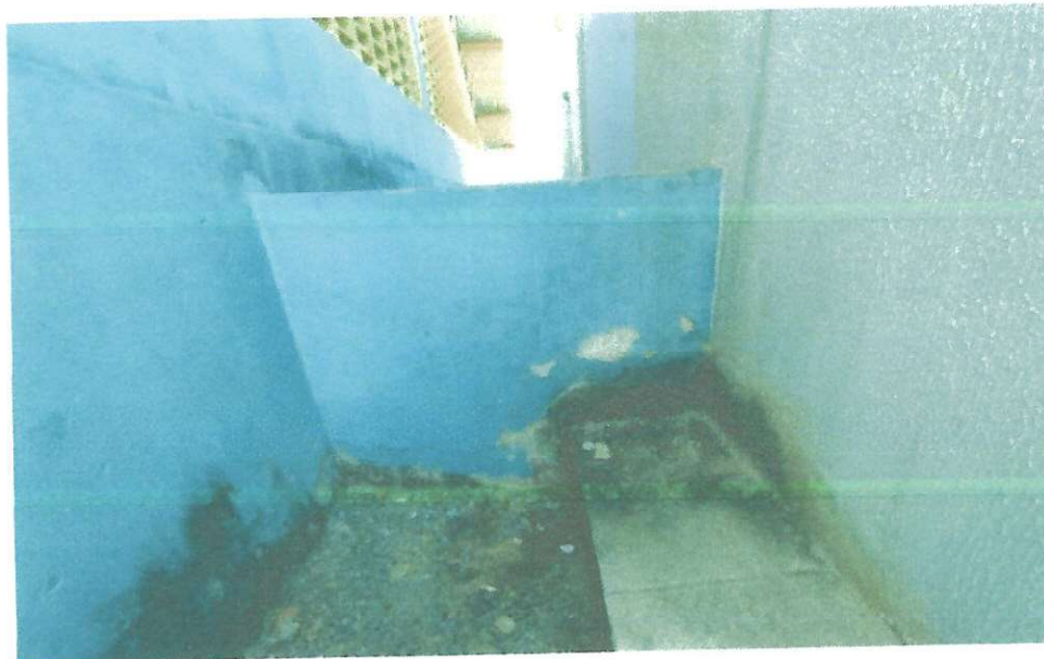
FOTO 09 – LOCAL DA COMPLEMENTAÇÃO DO MURO E REBOCO DANIFICADO
