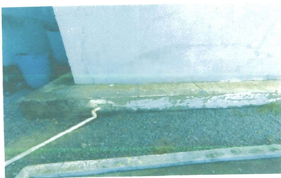
FOTO 10 – CALÇADA DE PROTEÇÃO DANIFICADA
