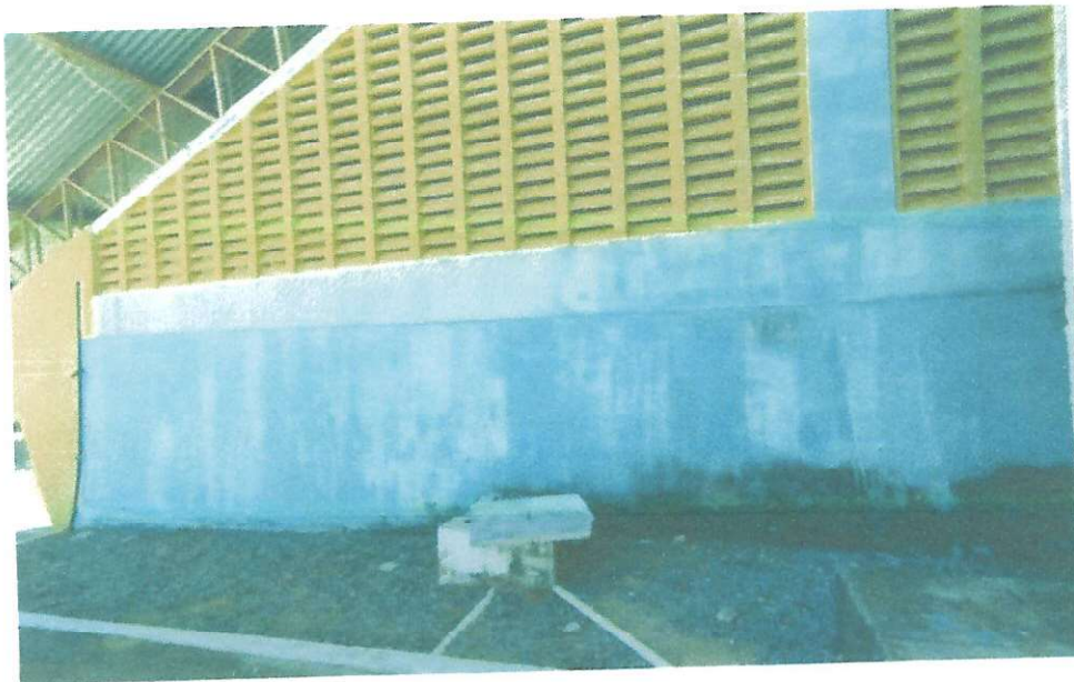
FOTO 07 – PINTURA DO MURO DANIFICADA
