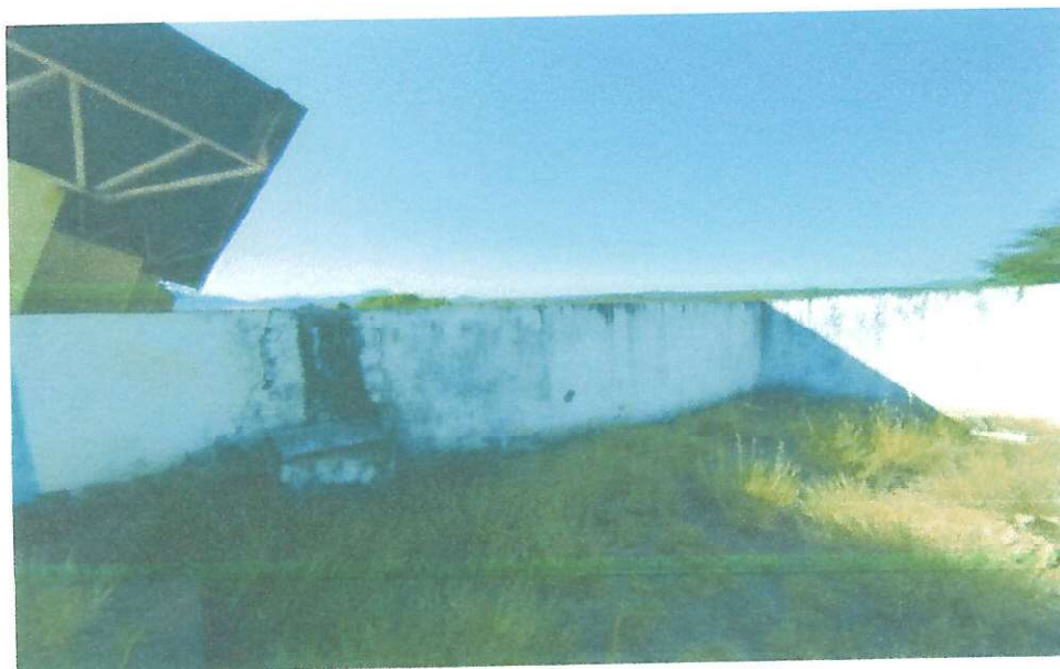
FOTO 06 – PINTURA DO MURO DANIFICADA
