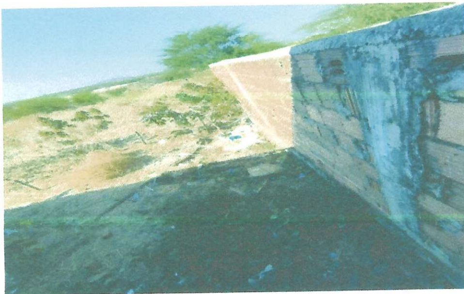
FOTO 11 – PAREDE DO MURO SEM REBOCO
