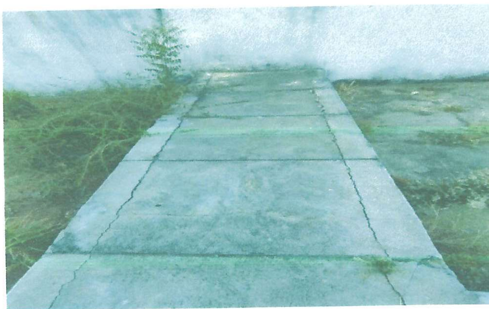
FOTO 30 – CALÇADA DO ESTACIONAMENTO DANIFICADA
