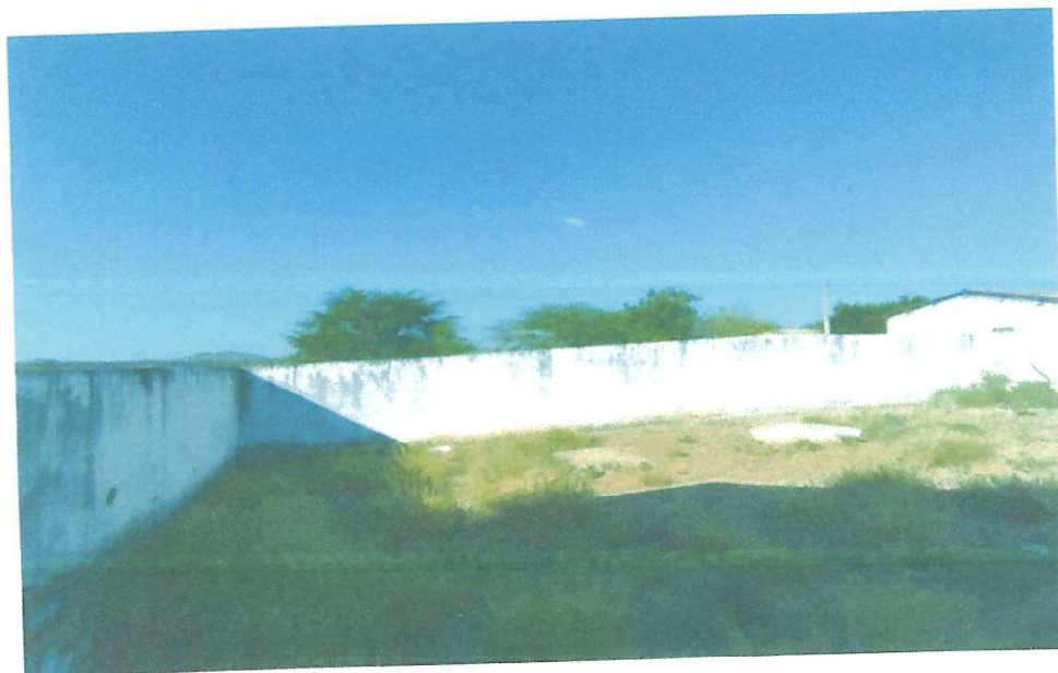
FOTO 08 – LOCAL DA COMPLEMENTAÇÃO DO MURO E PINTURA DO MURO DANIFICADA
