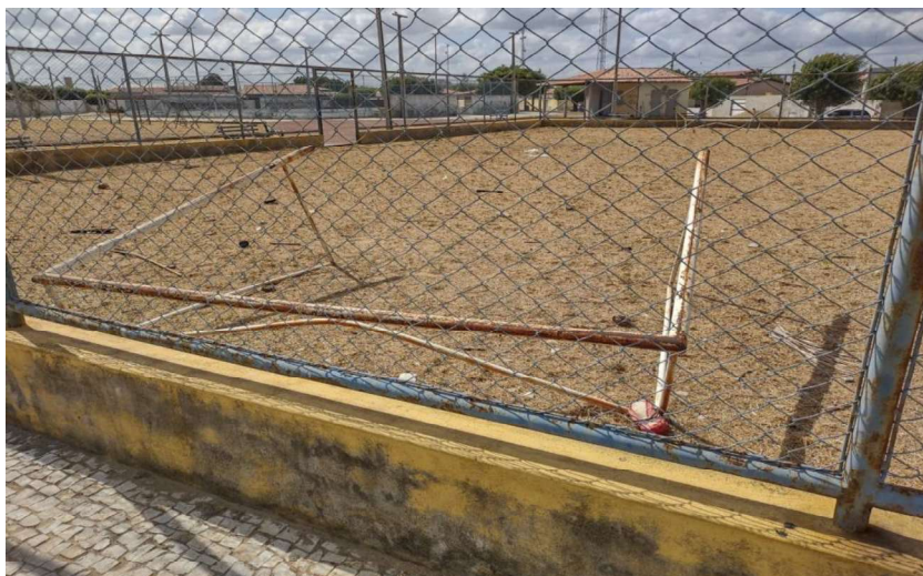
FOTO 07 – TRAVES DANIFICADAS E COM CORROSÃO
