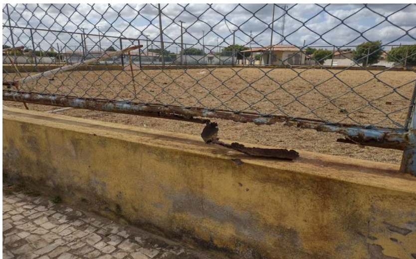
FOTO 03 – ALAMBRADO DANIFICADO COM CORROSÃO
