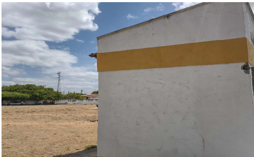
FOTO 05 – VESTIÁRIO COM PINTURA EXTERNA DESGASTADA E ALGUNS REBOCOS DANIFICADOS.
