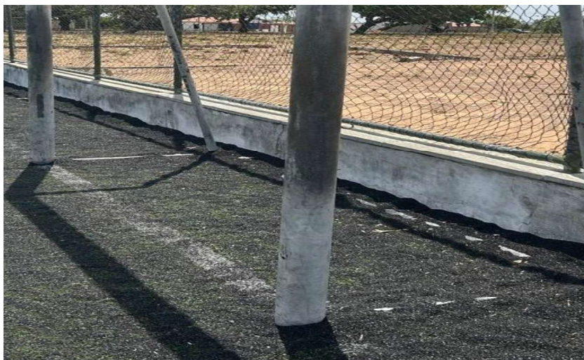
FOTO 01 – TRAVES DANIFICADAS E ENFERRUJADAS COM CORROSÃO.
