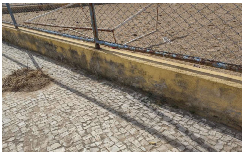
FOTO 06 – PINTURA DA MURETA DESGASTADA
