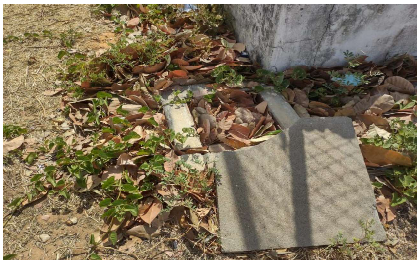
FOTO 15 – TAMPA DE CAIXAS DE INSPEÇÃO ELÉTRICA DANIFICADAS
