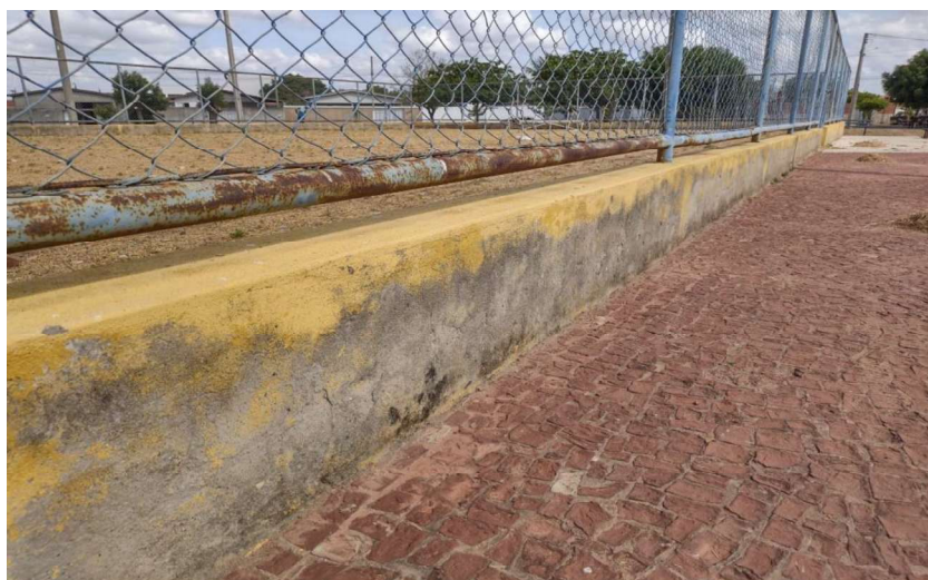
FOTO 05 – PINTURA DA MURETA DESGASTADA
