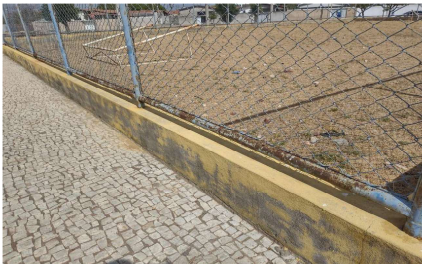
FOTO 02 – ALAMBRADO DANIFICADO COM CORROSÃO
