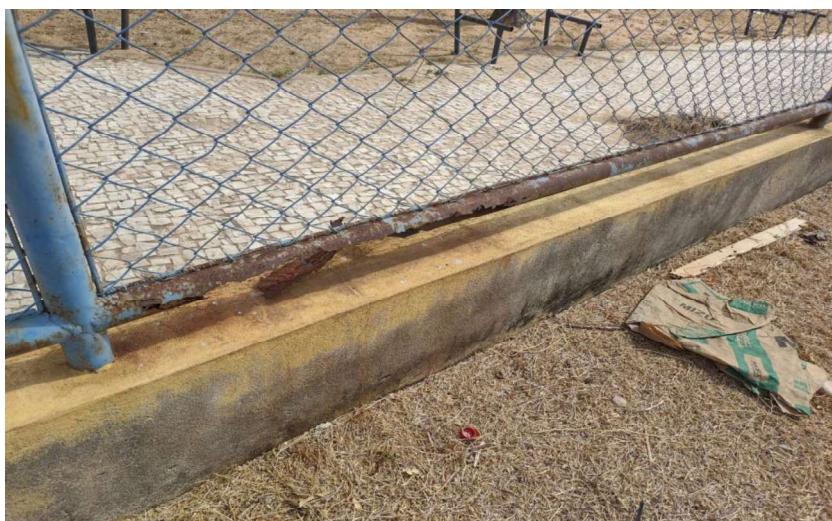
FOTO 01 – ALAMBRADO DANIFICADO COM CORROSÃO
