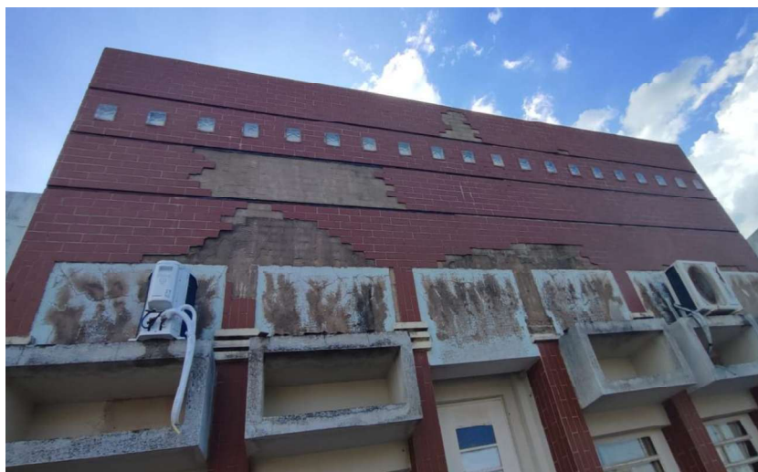
FOTO 02 – REVESTIMENTO CERAMICO DANIFICADO
