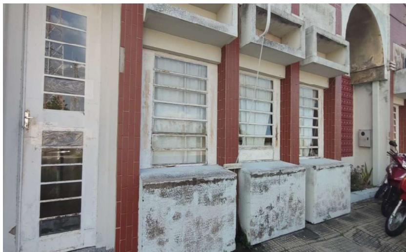
FOTO 11 – PINTURA DE PORTAS E JANELAS DANIFICADAS
