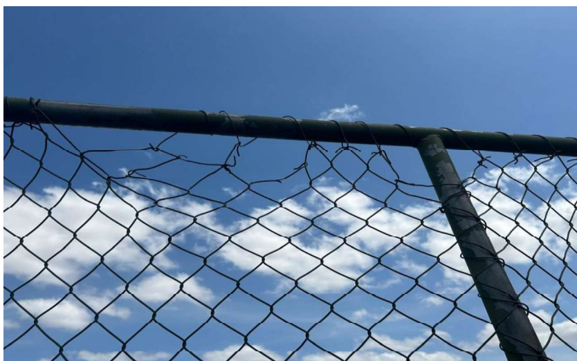
FOTO 04 – TELAS DANIFICADAS E ALONGADAS DEVIDO AO USO.
