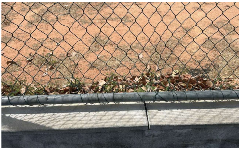
FOTO 03 – ALAMBRADOS DANIFICADOS E ENFERRUJADOS COM CORROSÃO.
