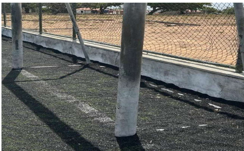
FOTO 01 – TRAVES DANIFICADAS E ENFERRUJADAS COM CORROSÃO.
