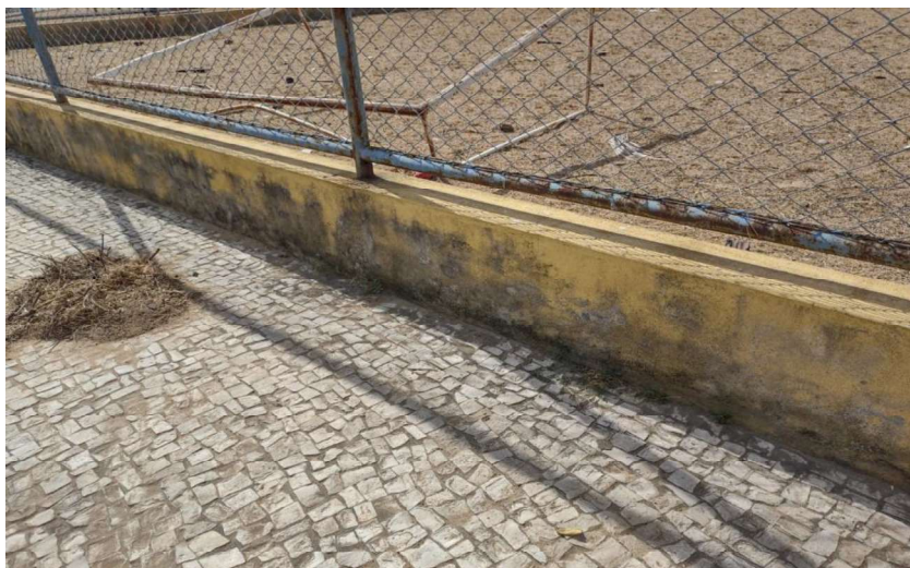
FOTO 06 – PINTURA DA MURETA DESGASTADA
