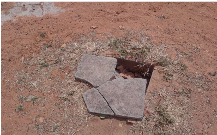
FOTO 16 – TAMPA DE CAIXAS DE INSPEÇÃO ELÉTRICA DANIFICADAS
