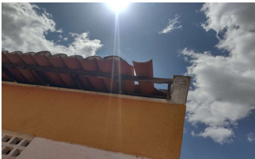
FOTO 06 – TELHADO VESTIÁRIO COM VÁRIAS TELHAS QUEBRADAS .
