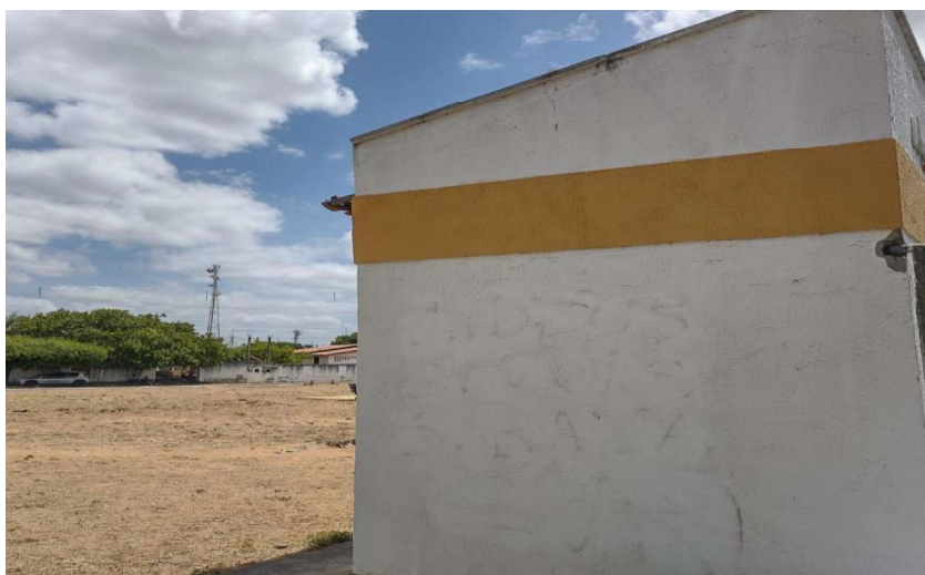
FOTO 05 – VESTIÁRIO COM PINTURA EXTERNA DESGASTADA E ALGUNS REBOCOS DANIFICADOS.
