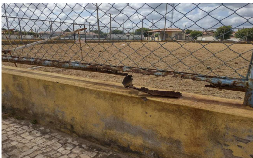
FOTO 03 – ALAMBRADO DANIFICADO COM CORROSÃO
