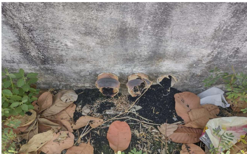
FOTO 07 – TUBOS DE DRENAGEM DANIFICADOS
