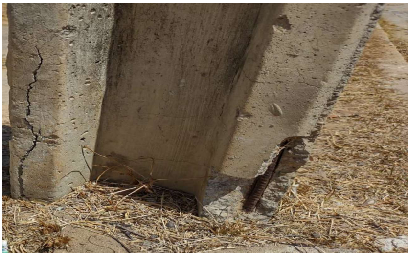
FOTO 13 – POSTES EXISTENTES DANIFICADOS
