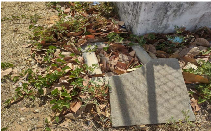
FOTO 15 – TAMPA DE CAIXAS DE INSPEÇÃO ELÉTRICA DANIFICADAS
