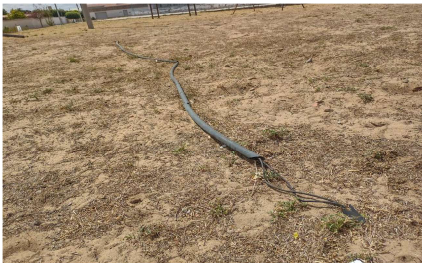
FOTO 11 – INSTALAÇÕES ELÉTRICAS DANIFICADAS (ELETRODUTOS EXPOSTOS, QUEBRADOS EM VÁRIOS LOCAIS E FIAÇÕES EXPOSTAS, DESEMCAPADAS E QUEBRADAS DEVIDO A EXPOSIÇÃO AO SOL).
