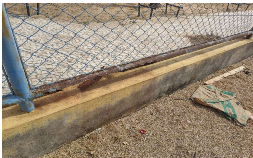
FOTO 01 – ALAMBRADO DANIFICADO COM CORROSÃO
