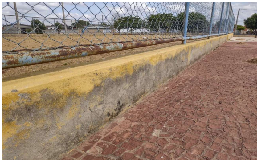
FOTO 05 – PINTURA DA MURETA DESGASTADA
