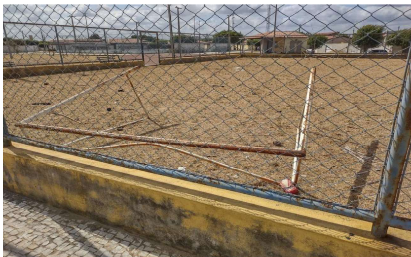
FOTO 07 – TRAVES DANIFICADAS E COM CORROSÃO
